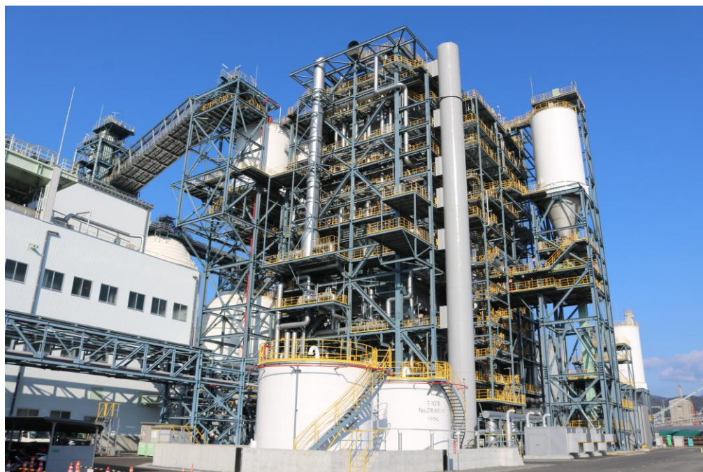
バイオマスボイラ(全景)
