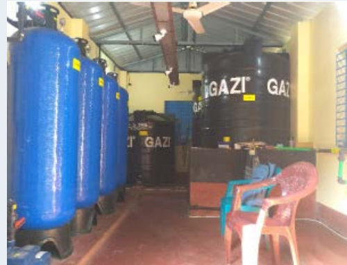
プラント内水処理設備
