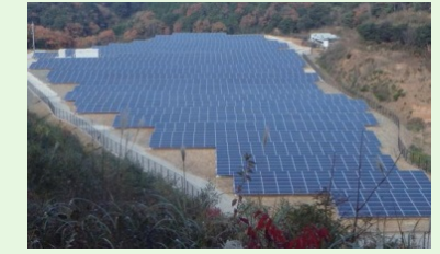
アンビックスソーラー浜田 (島根県浜田市) ● 発電出力1,332kw (パネル設置枚数5,124枚) ● 太陽光発電システム (株) 日立システムズ ● 定格出力1,000kw ● 2015年12月から売電開始
