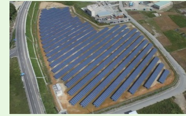
田老太陽光発電所 (岩手県宮古市) (2) ● 発電出力2,356kw (パネル設置枚数9,240枚) ● 太陽光発電システム (株) 日立製作所 ● 定格出力 1,980kw ● 2015年10月から売電開始
