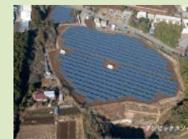
メガソーラー発電所運転
